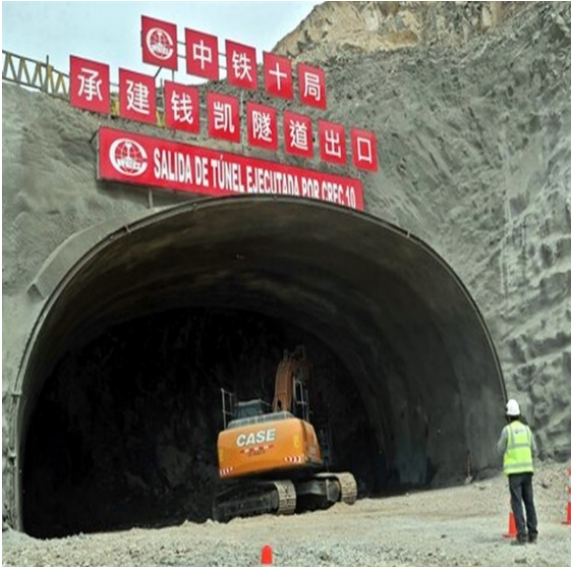
Foto N°2: Perforación de túnel y ejecución de dos puentes en el Terminal Portuario de Chancay
